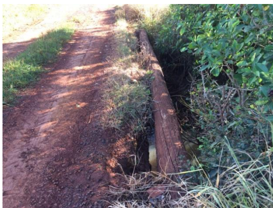
Figura 21 – Longarina desintegrada da estrutura da ponte sobre o Córrego Douradinho Fonte: Próprio autor (2019)
