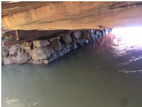
Figura 20 – Fissuras em uma das longarinas da ponte sobre o Ribeirão Abóbora Fonte: Próprio autor (2019)
