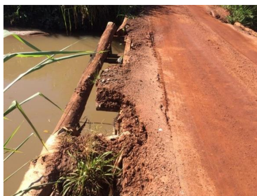
Figura 22 – Longarina desintegrada da estrutura da ponte sobre o Ribeirão Abóbora Fonte: Próprio autor (2019)
